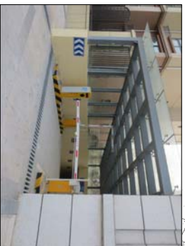
一号地块排水设施
