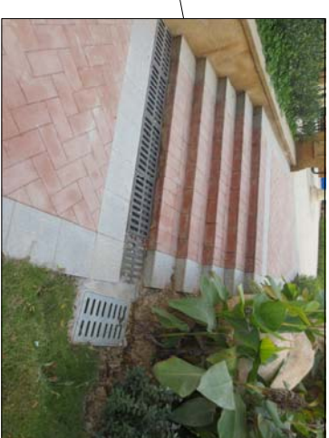
二号地块排水设施
